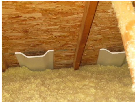
Soffit vent baffles
